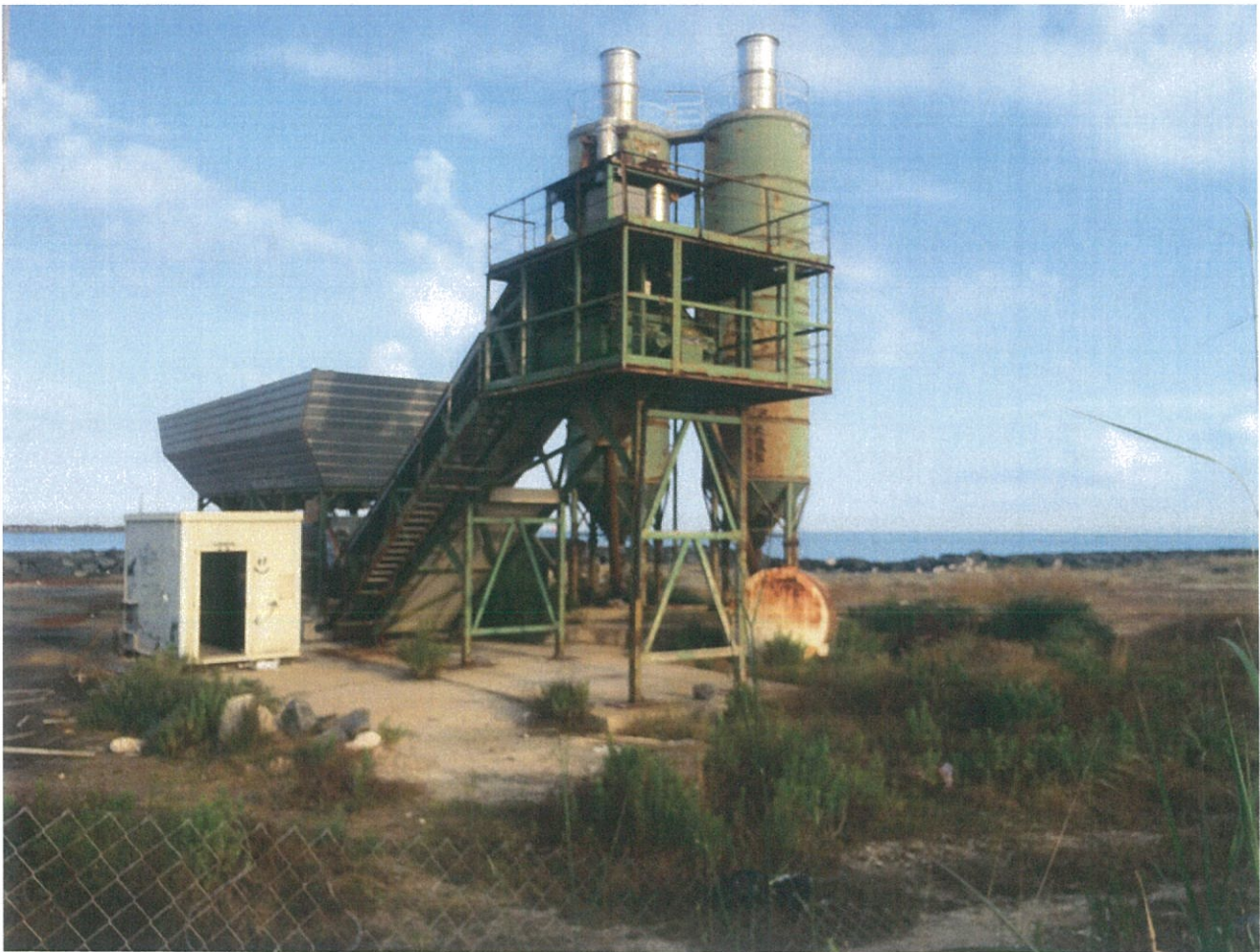
Foto 3.4 Impianto di betonaggio
